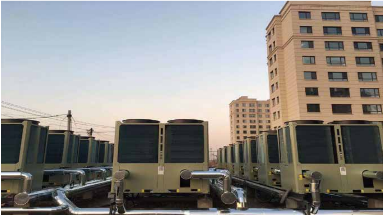
项目名称： 辽宁省鞍山市王坨子新村空气源热泵供热项目 项目简介： 项目位于辽宁省鞍山市台安县，采暖面积43000m²，冬季温度较低。在供暖期内，住户室内温度达到22℃以上，供热效果良好，能耗仅为35kWh/m²/采暖季。该项目已成为东北地区，尤其是辽南地区住宅类项目空气能热泵供热的标杆。
