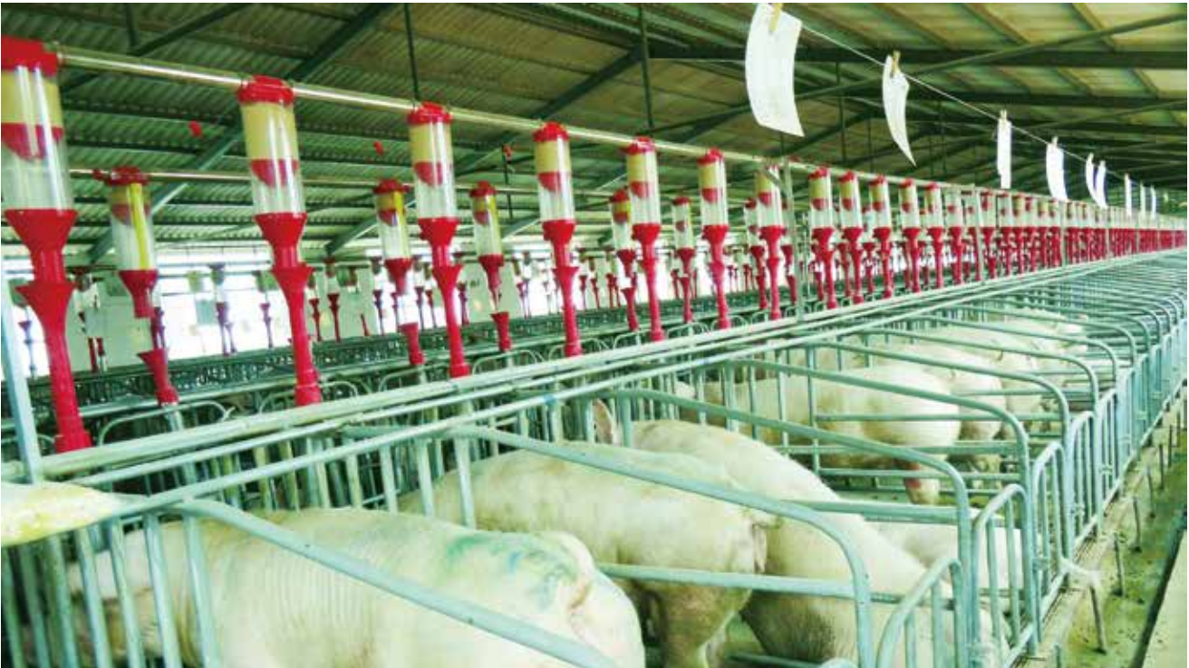
项目名称： 北京良山畜牧场采暖改造项目 项目简介： 项目畜牧场为猪、牛类养殖，供暖改造面积35,000㎡，共使用72台不同型号的空气源热泵机组。该项目搭载了海悟云远程监控系统，根据不同生产阶段预设参数指标，自动调节室内温度和有害气体含量；实时掌握畜牧场温度和空气状态。
