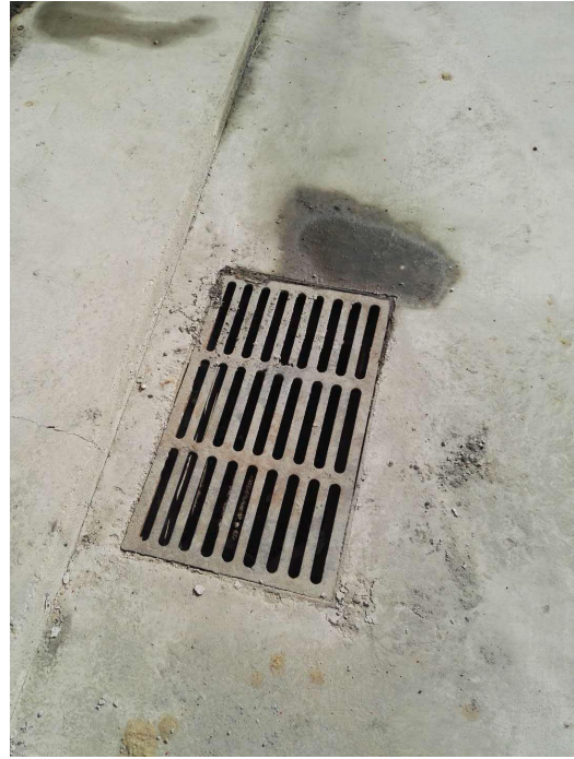
雨水收集系统
