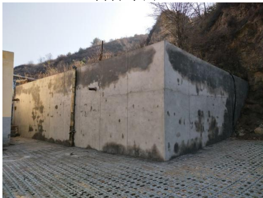
矿井水处理站事故水池
